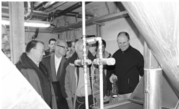
Eng ging es zu im Heizraum der Brauerei, aber die Technik imponierte.
